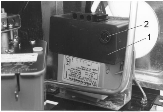
Abbildung 16: Zündtransformator 1 Zündtransformator 2 Schraubkappe mit Feinsicherung M 500 mA, 250V
